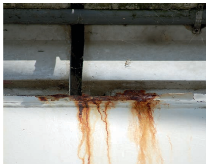
De Calatrava-bridgen over de Hoofdvaart. Bij het plaatsen waren de randelementen niet waterdicht verlijmd.
